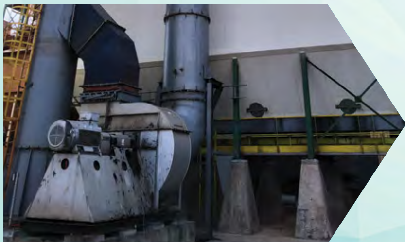
Врекест филтер во Подготовка на руда – Мелење
